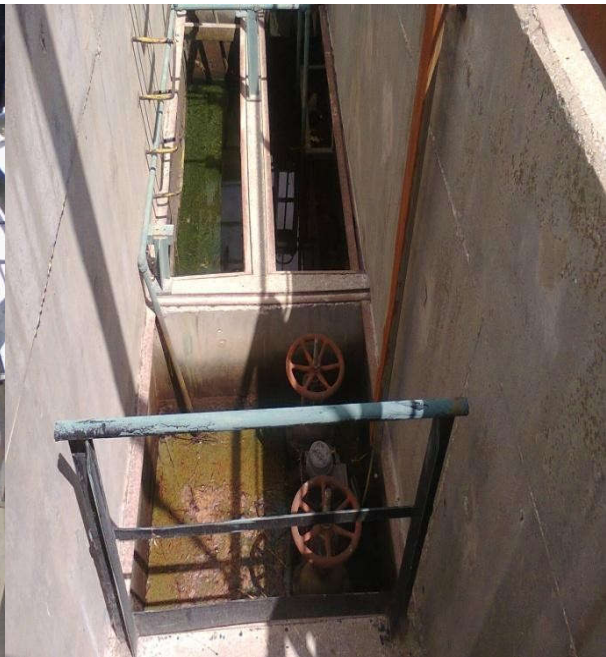
Figure V.2 : Bassin de dessablage déshuilage de la ligne d'élimination des hydrocarbures.
