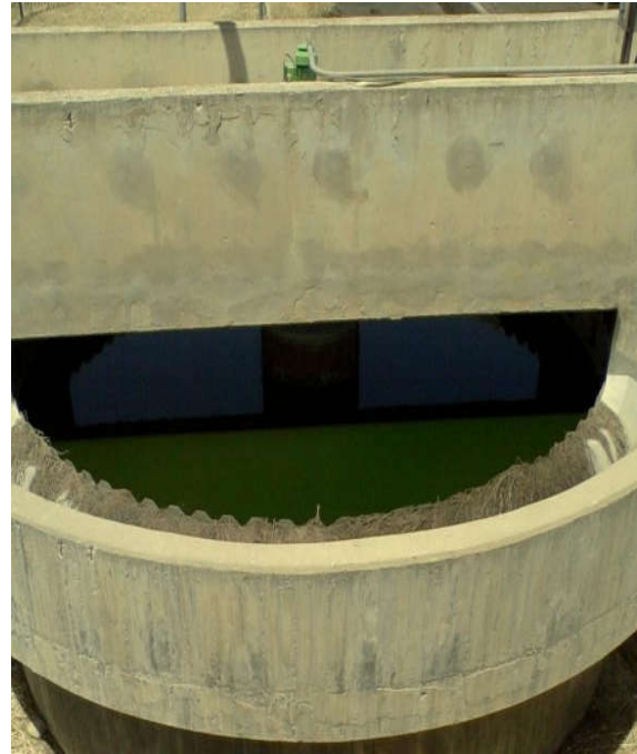
Figure V.4 : Etat du clarificateur actuel
