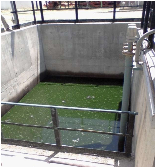
Figure V.1 : Bassin de dessablage-déshuilage de la ligne de traitement des eaux sanitaires
