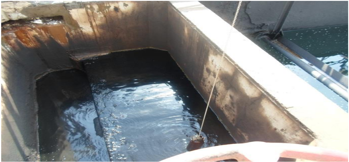
Figure : prélèvement d'échantillon en amont des filtres à foin
