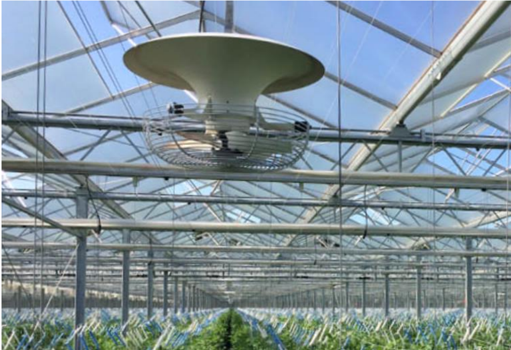
Figure 1-6 Ventilateur de serre
