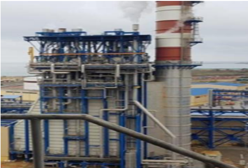
Figure1.11 : chaudières de récupération
