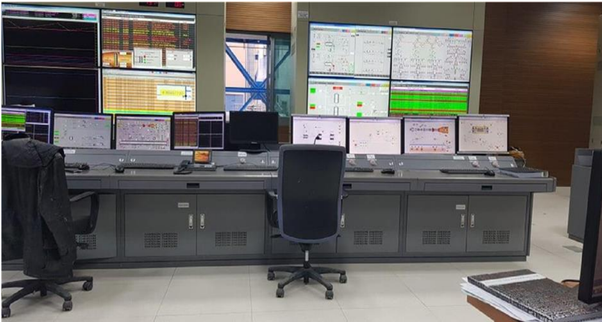
Figure1.13 : la salle de commande de la nouvelle centrale CAP-DJINET.
