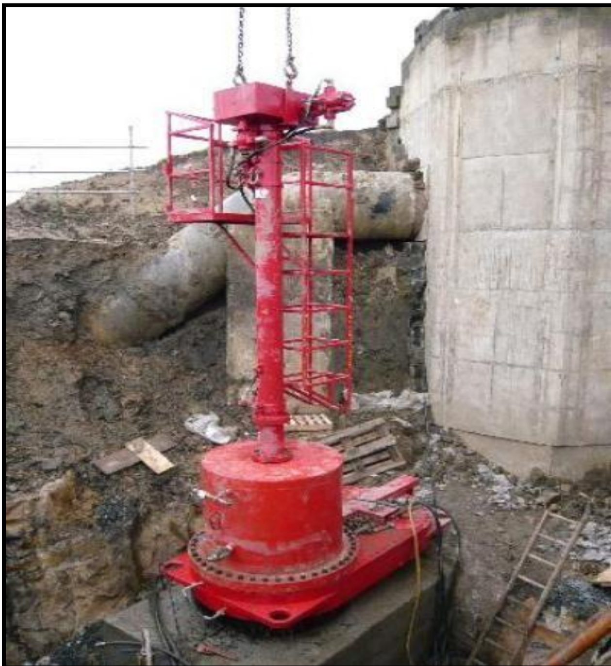
FIG.II.5 : Image réelle d'un piquage en charge,[6].
