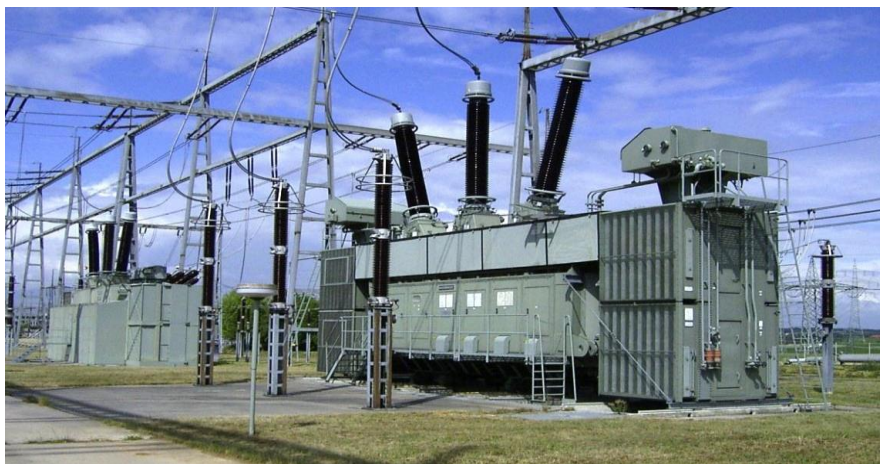
Figure II-17 Transformateur de puissance.
