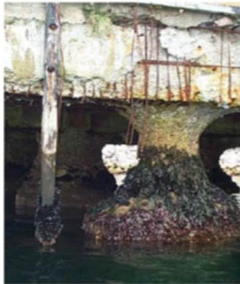
Figure I.14 Béton dégradé en zone de marnage (© Hervé Barreda, CEREMA) [106].
