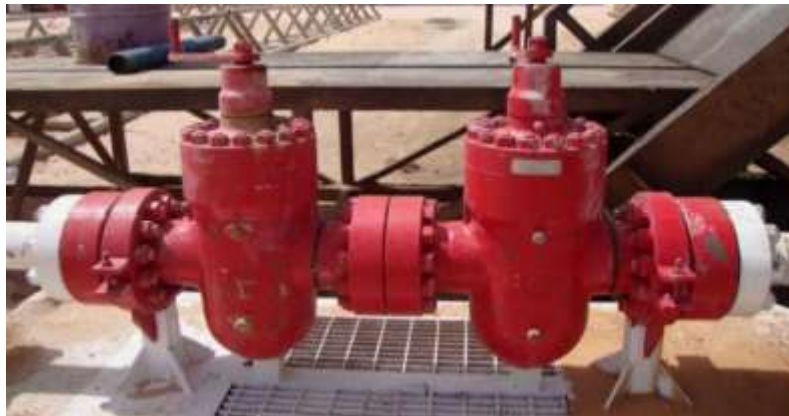
FIGURE 28 : LA VANNE ESD (MANUELLE) [32]
