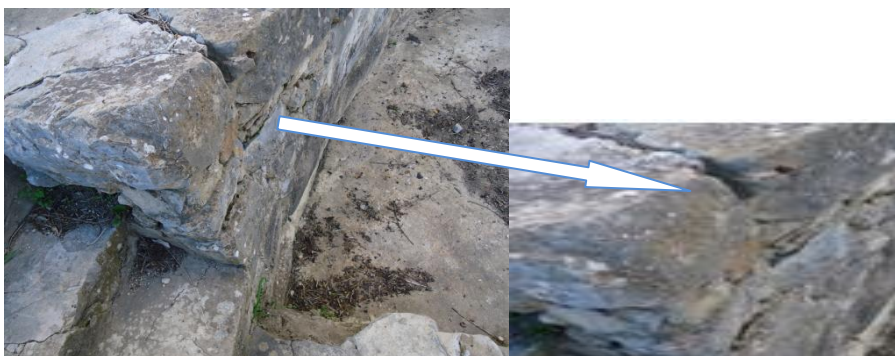
Fig.46. Fissuration de mortier de jointement du mur extérieur de la piscine. (M. Belaidi).
