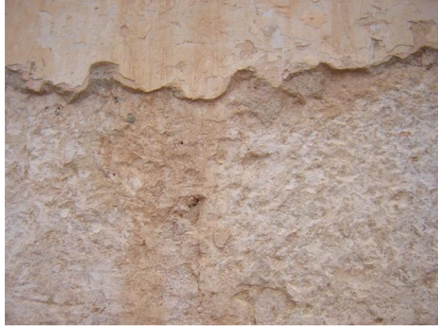
Fig.21 .Manque d'adhérence des mortiers
