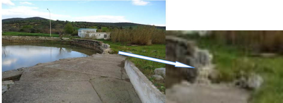
Fig.41. Photo d'effondrement d'une partie situé au nord est d'un mur de la piscine (M. Belaidi).
