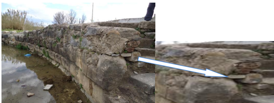
Fig.43. Perte de masse des pierres à l'intérieur du mur de la piscine. (M. Belaidi).
