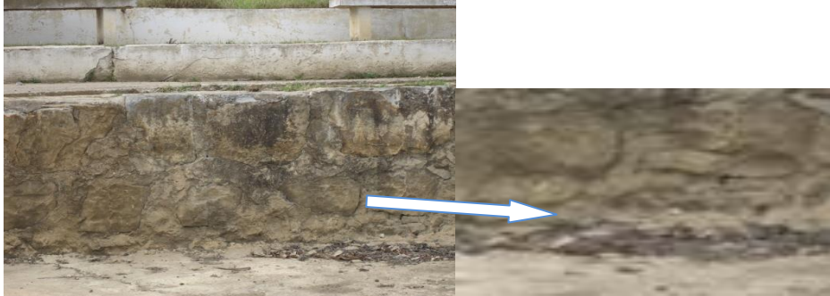
Fig.44. Perforations des pierres du mur intérieur de la piscine. (M. Belaidi).
