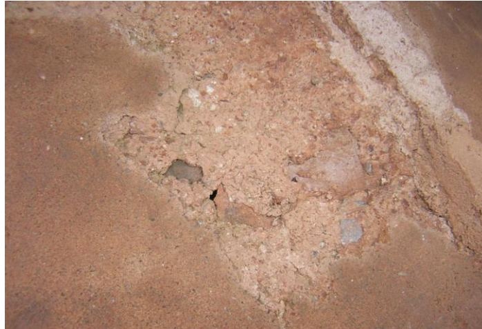
Fig.22. Présence de fissure dans le mortier
