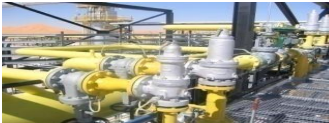
Figure III. 3: Soupape de sécurité
