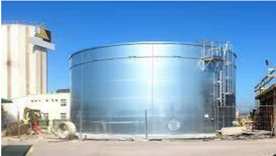
Figure II.20 : bac de réservoir métallique
