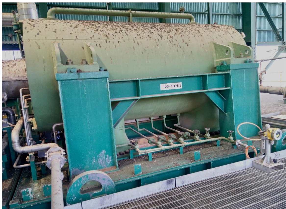
Figure.III.3. Compresseur 60MB7-6 installé sur site.
