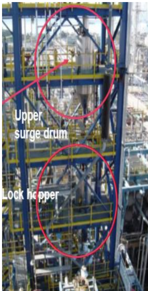
Figure III.9 : Description détaillé de Réservoir tampon supérieur (520-D-051) et de la Trémie verrouillable (520-D-052).
