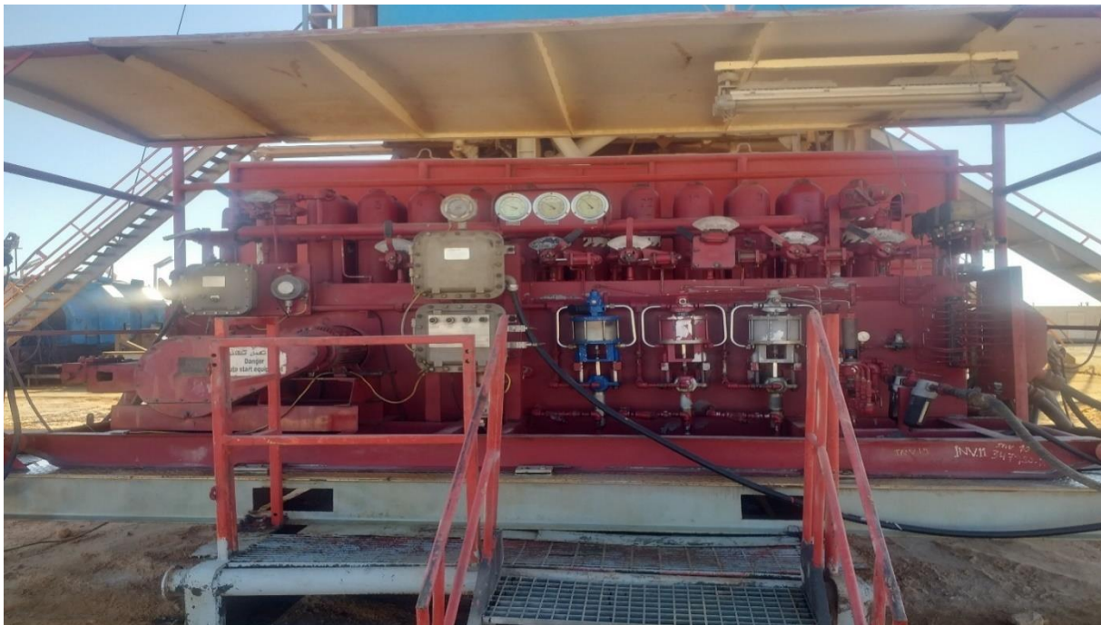
Figure 1. 12 : Unité d'accumulation et de commande des BOP.
