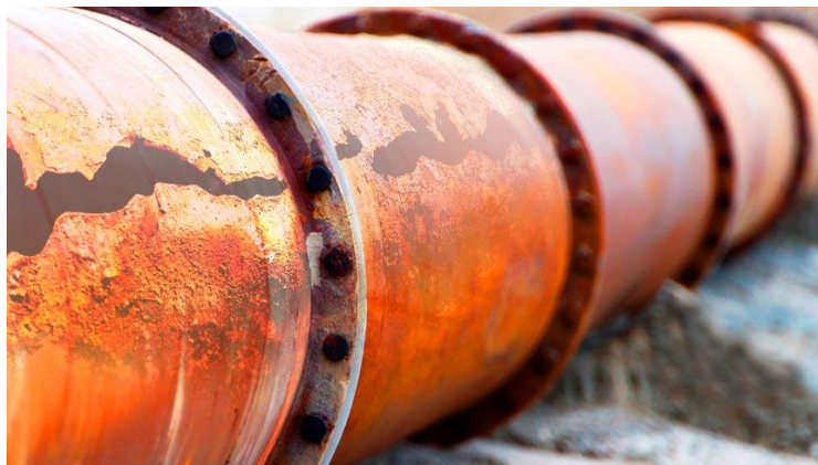
Figure II. 1: représentation d'un exemple de corrosion
