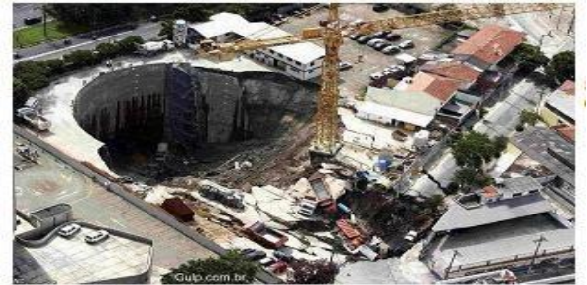
Figure 2-3 : Effondrement de la station de métro Sao Paulo 01-2007
