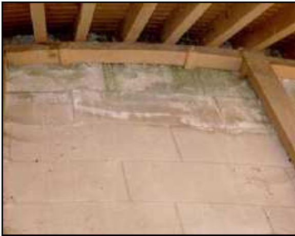
Figure 26: Efflorescence sous charpente capillaires mal isolée.
