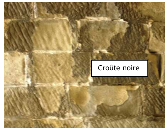
Figure 16: Détachement de croûtes noires d'un mur
