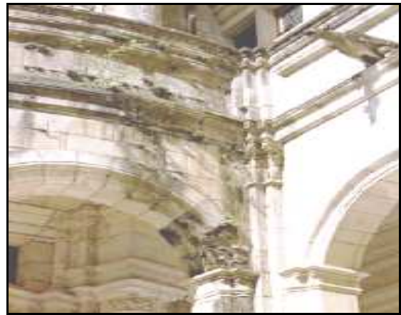
Figure 33 : Développement d'herbes et d'arbustes entre les joints de pierre [15].
