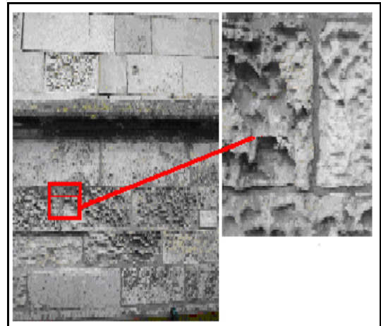
Figure 21 : Désagrégation sableuse par alvéolisation [10]
