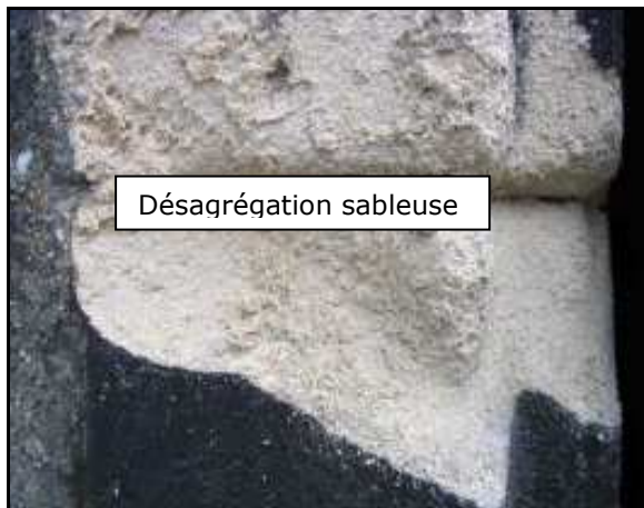
Figure 20: Désagrégation sableuse sur un mur en pierre calcaire [15]
