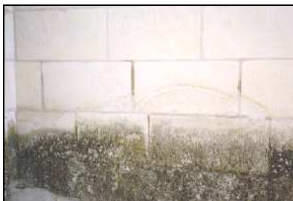
Figure 31 : Développement de mousses et de lichens à la base d'un mur en pierre calcaire [15].
