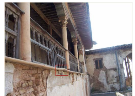
Fig. n° 8 : Effets du mauvais choix des mortiers de réparation (mortier à base du ciment).
