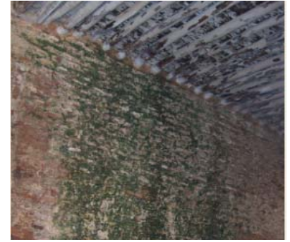
Fig. n° 17 : Présence d'algues sur le mur intérieur des cuisines du Dey.
