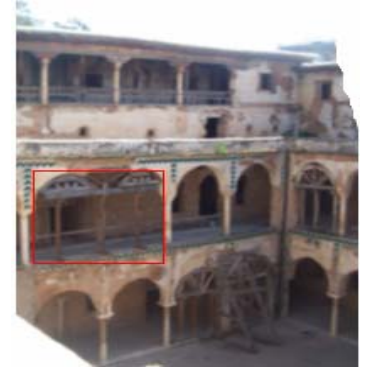
Fig. n° 9 : Photo montrant une structure éayée, palais du Dey.
