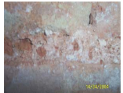
Fig. n° 14 : Photo montrant la présence des taches d'efflorescence sur la surface du mur- Citadelle d'Alger
