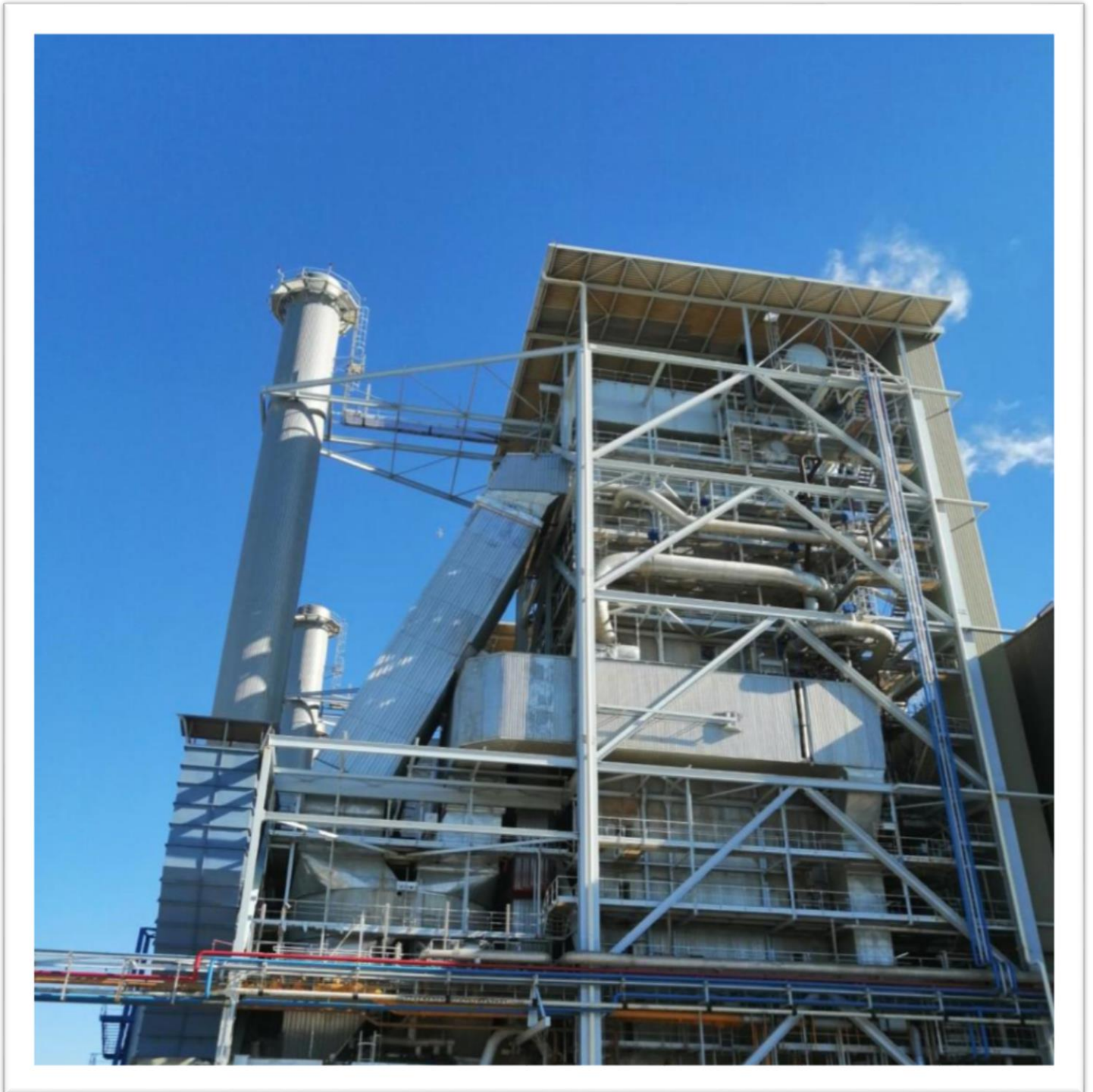
Figure 17 : Photo réelle de la chaudière de la centrale thermique de CAP-DJINET.
