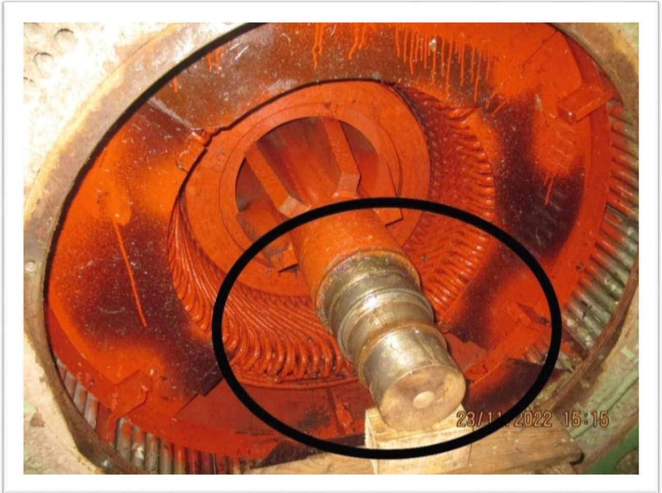
Figure 21 : Défaut de roulement de moteur ventilateur
