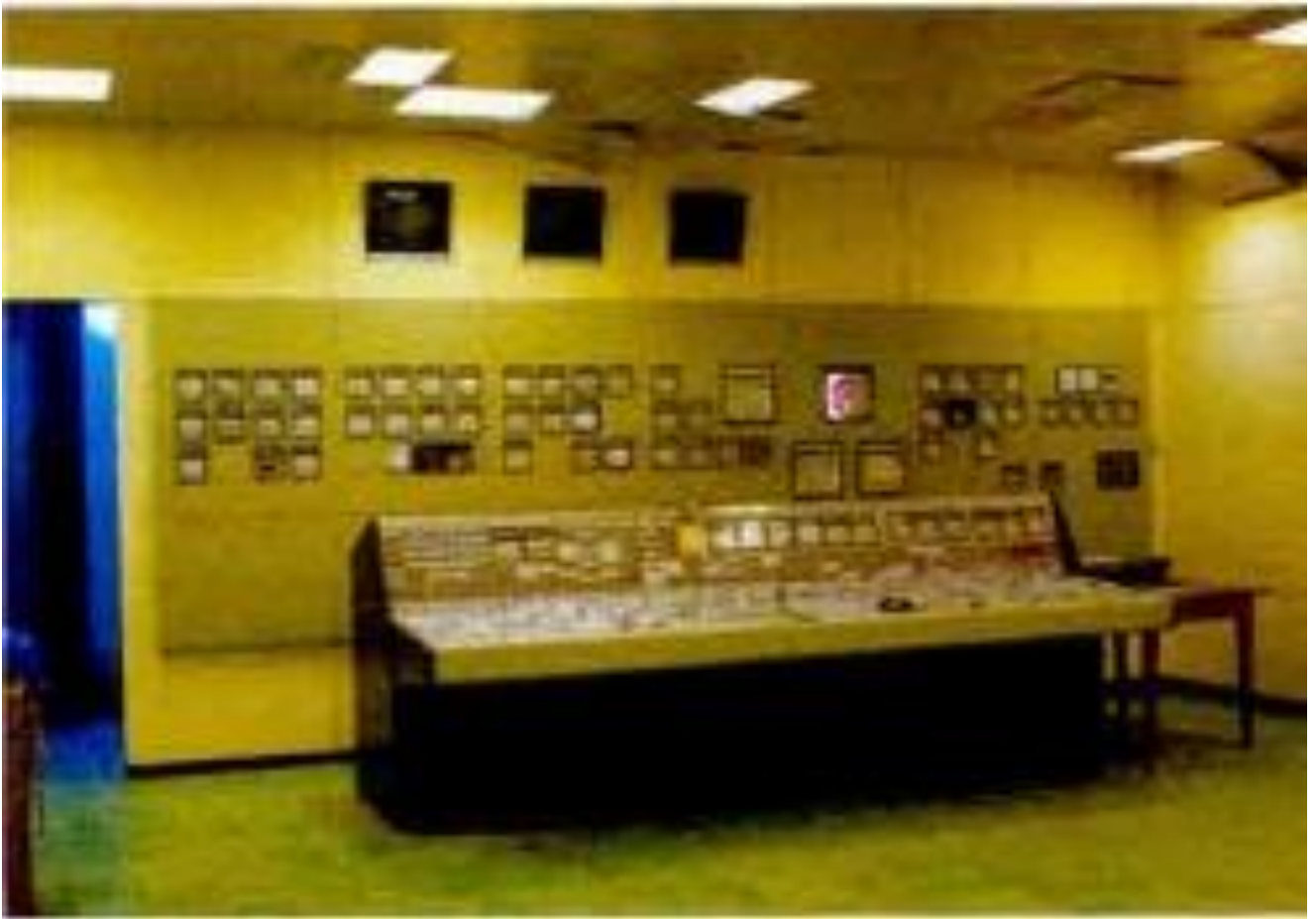
Figure 15 : Salle de commande
