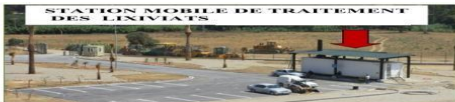
Figure N°10: station de traitement des Lixiviats
