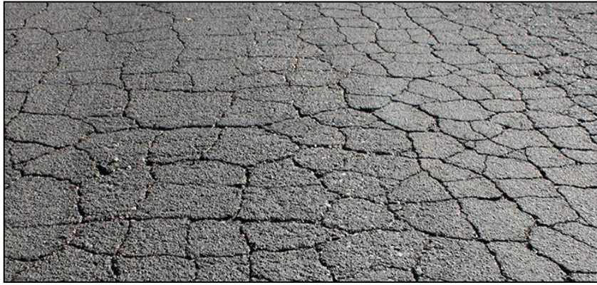
Figure I.18. Faïençage au niveau d'une chaussée
