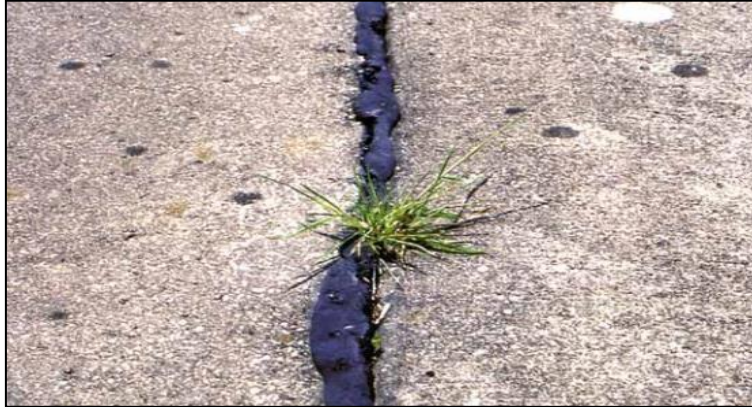
Figure I.31 : Mauvaise adhérence révélée par la présence de végétation.
