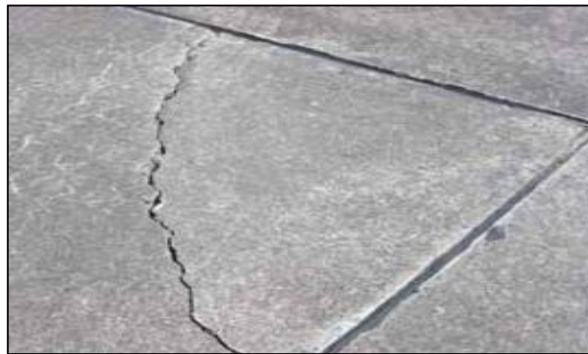
Figure I.24 : Fissure de coins
