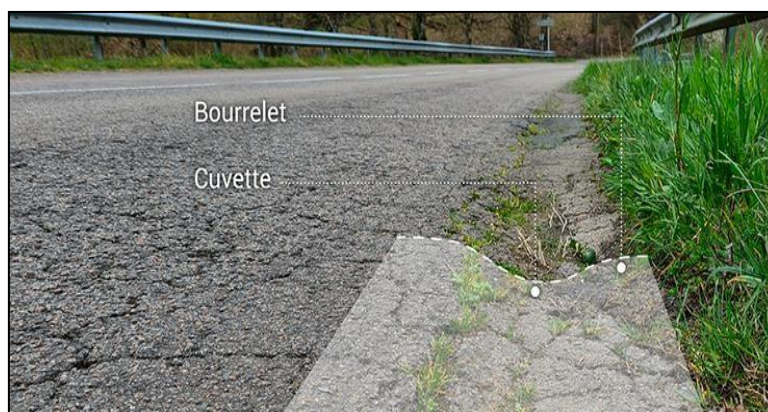
Figure I.13 Affaissement de rive au niveau d'une chaussée
