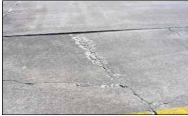
Figure I.25 : Fracture de la dalle en béton
