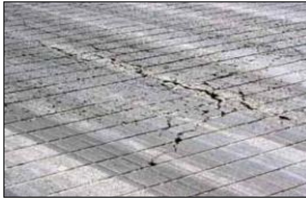
Figure I.29 : Vue de faiençage.
