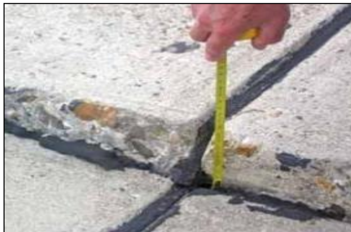
Figure I.27 : Décalage des parties aux niveaux des joints
