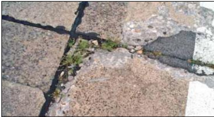
Figure I.28: Vue des épaufrures au niveau de la surface
