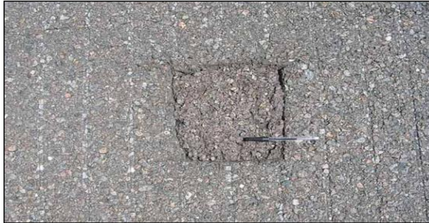
Figure I.32: Réparation ponctuelle dégradée [15]
