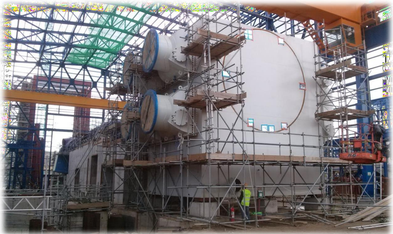
Figure 2.22. Photo de condenseur de la centrale RAS DJINET CC
