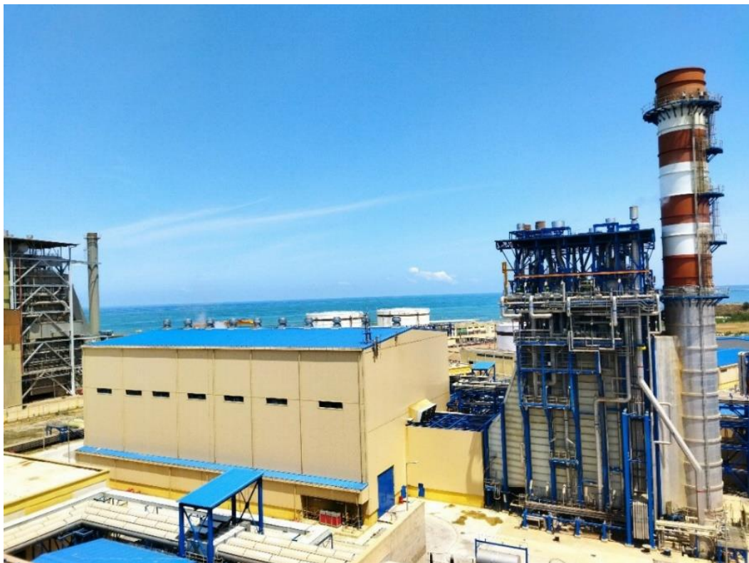
Figure 2.15. Photo de la chaudière de récupération de la centrale de RAS DJINET
