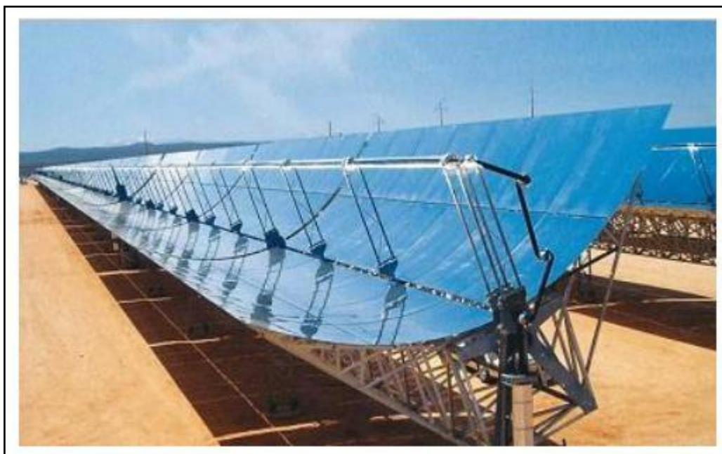
Figure 1.2. Centrale constituée de capteurs cylindro-paraboliques
