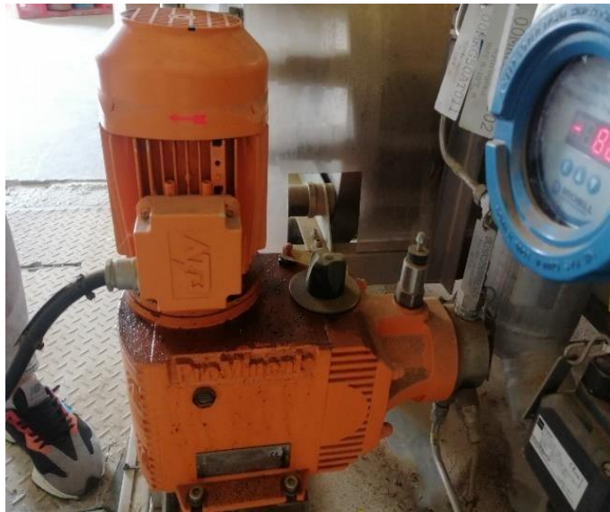
Figure III.9. Pompe à eau déminéralisée
