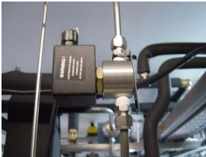
Figure V.10. Remplacement de l'électrovanne
