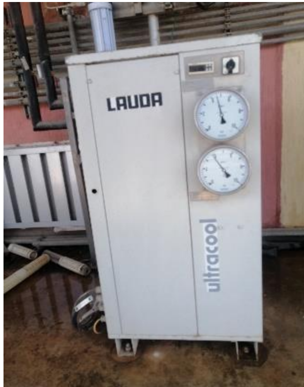
Figure III.15. Refroidisseur de gaz
