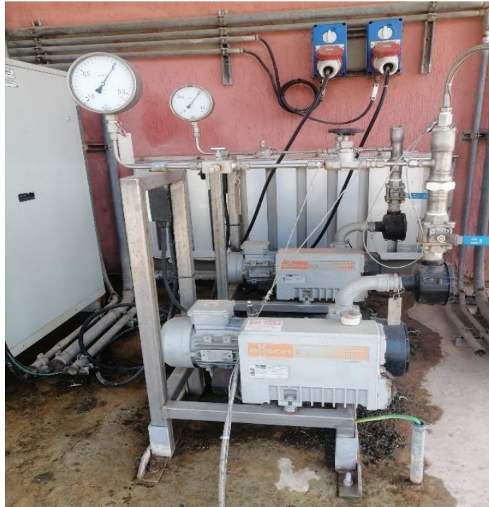
Figure III.20. Pompe à vide.
