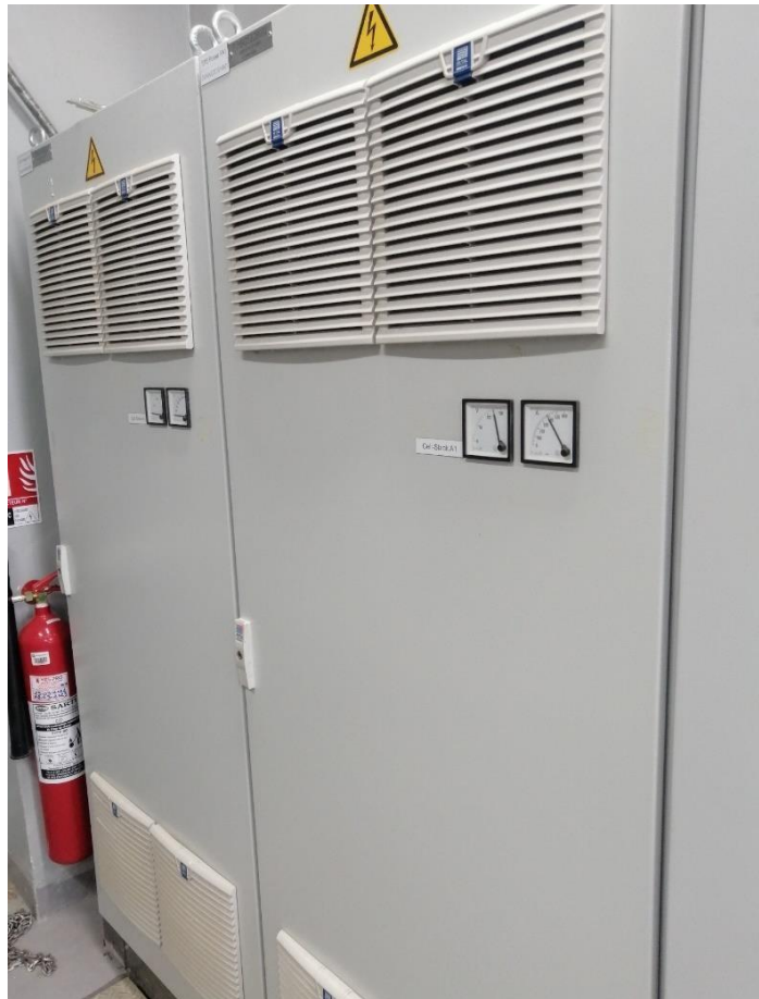
Figure III .21. Armoire électrique de l'EPS
