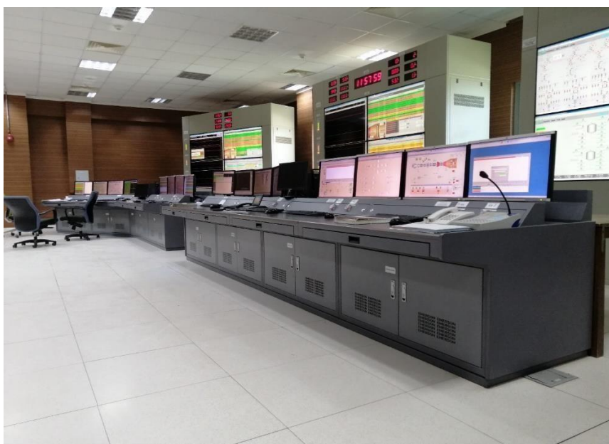
Figure 15. Salle de commande de la centrale à cycle combiné.
