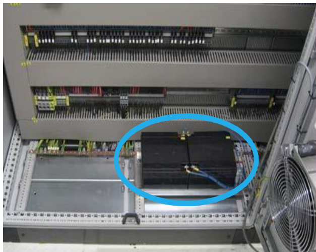
Figure V.13. Batteries UPS 24 V à l'intérieur du tableau de commande
