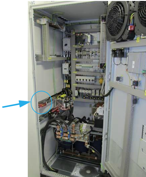
Figure V.15. Contrôle du fonctionnement de l'interrupteur de porte de l'armoire électrique
