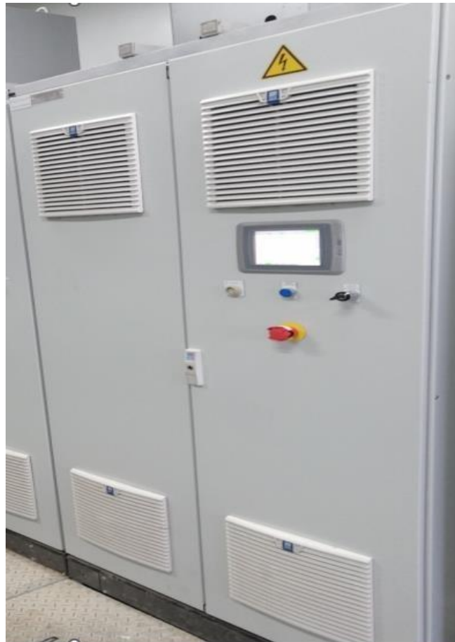
Figure III.23. Tableau principal (MP) et tableau de commande du compresseur
