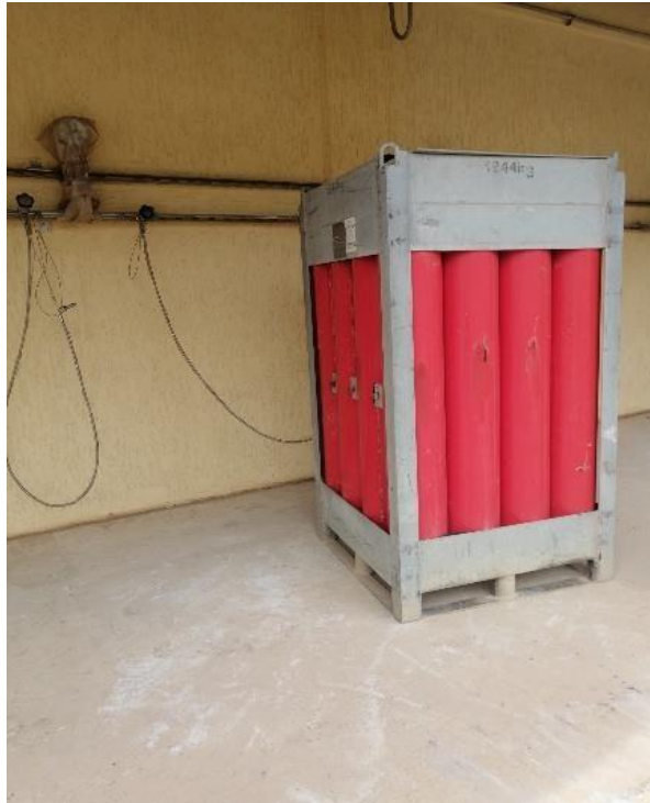
Figure III.19. Poste de remplissage des bouteilles
