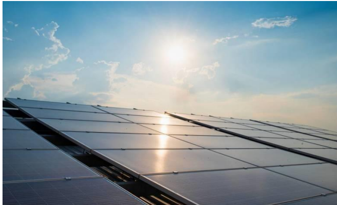
Figure 3 : Panneaux photovoltaïques dans l'Aude. (Photo : J.-P. Kern, médiathèque EDF)
