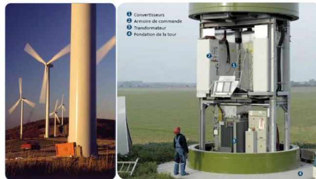
Figure 3. 9. Décryptage des éléments électroniques logés à l'intérieur de la tour éolienne [9]
