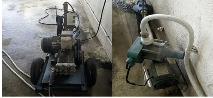
Fig 2. 10. Les moteurs de nettoyage quotidien
