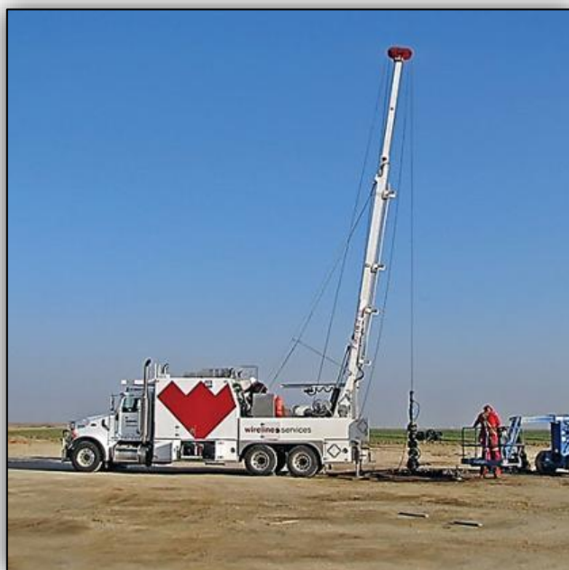
Figure II. 9: Unité de Wireline et slickline
