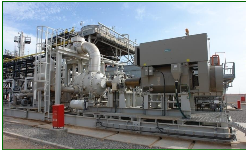
Figure III.5 : Compresseur Howden boucle propane.
