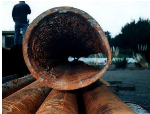
FIGURE 3.1 – Éclatement de tubage dû à une usure excessive
