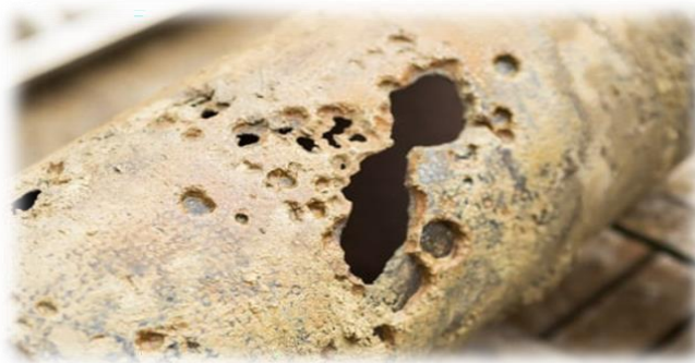
Figure 5: Corrosion par piqûres
