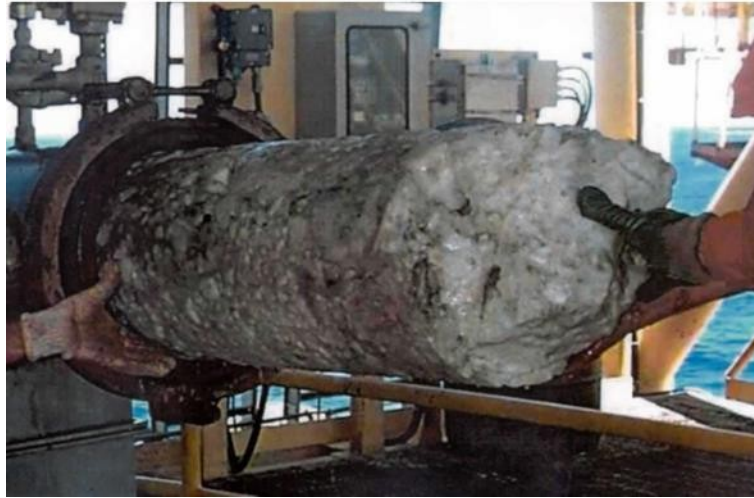
Hydrate sorti d'une canalisation.
