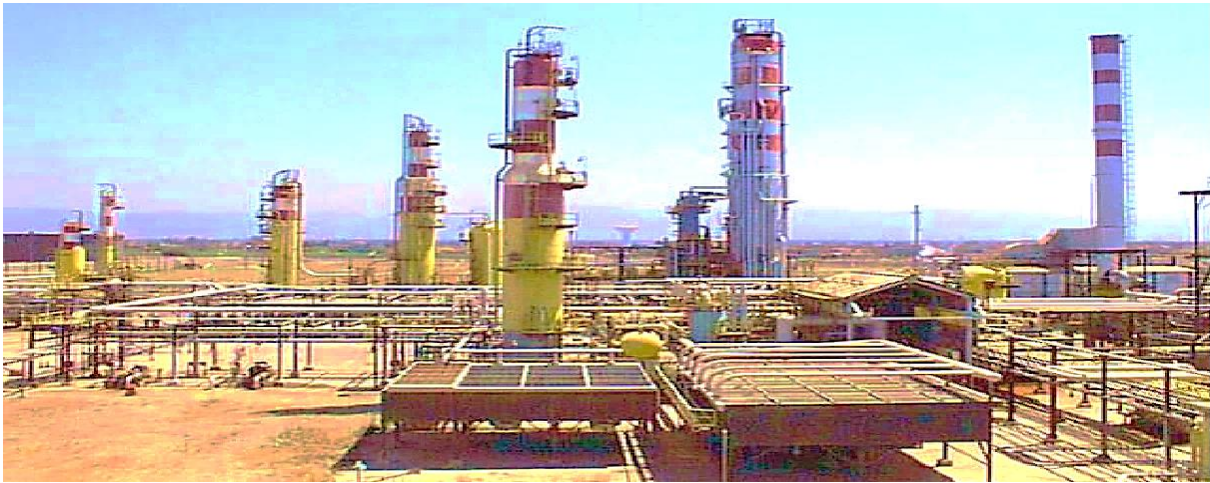
Figure I.9 : Unité de gaz plant(U300)
