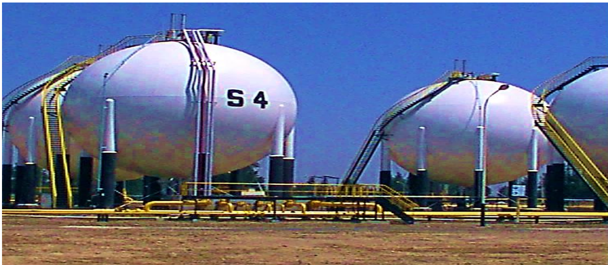
Figure I.19 : Sphère de stockage des GAZ liquide « propane et butane »
