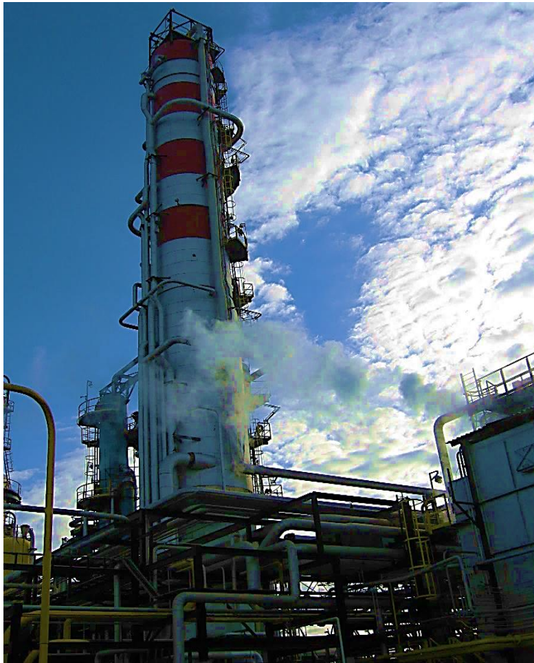
Figure I.8 : la colonne de distillation atmosphérique
