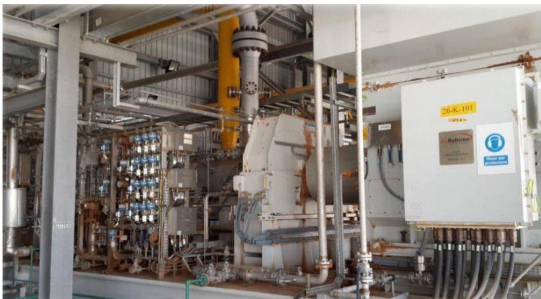
Figure I-3 compresseur gaz lift
