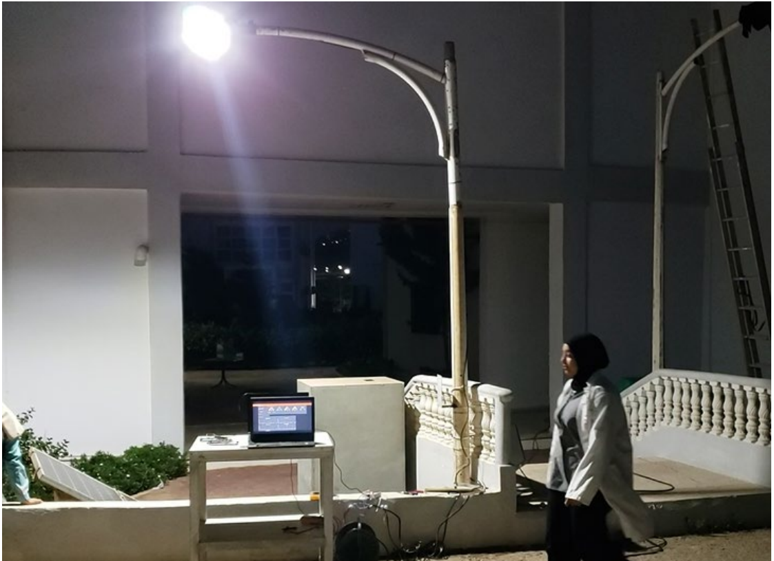
Figure IV. 25 Le système globale réalisé avec luminaire à niveau 100%.
