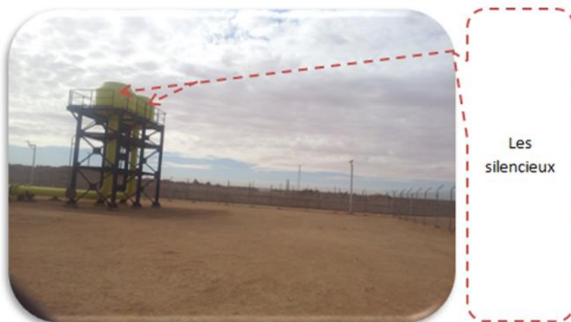
Figure 1.4 : Silencieux d'évent du site TFT.
