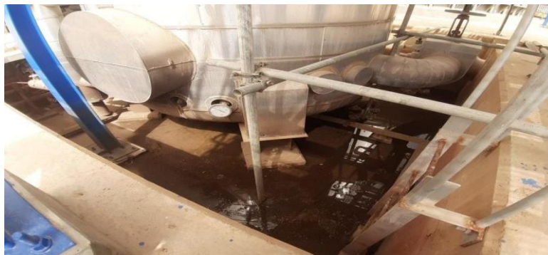
Figure [II.3] : Siphon de décharge d'excès d'eau en urgence
