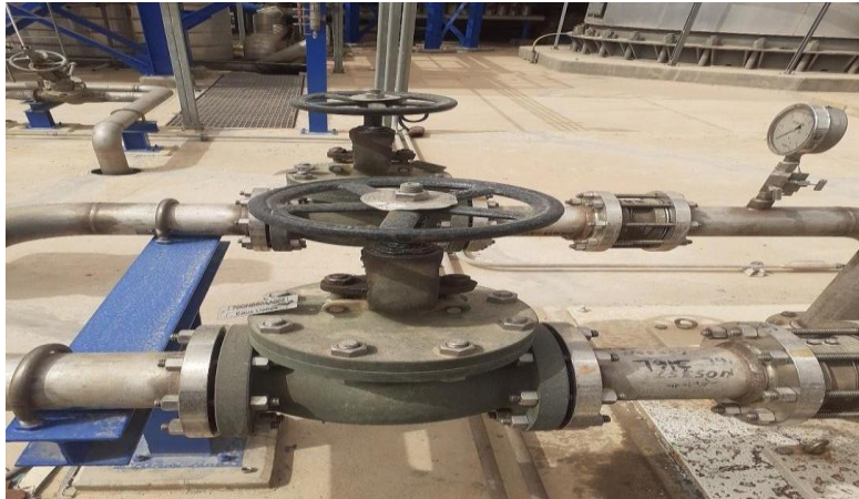
Figure [II.16] : Vanne de rejet
