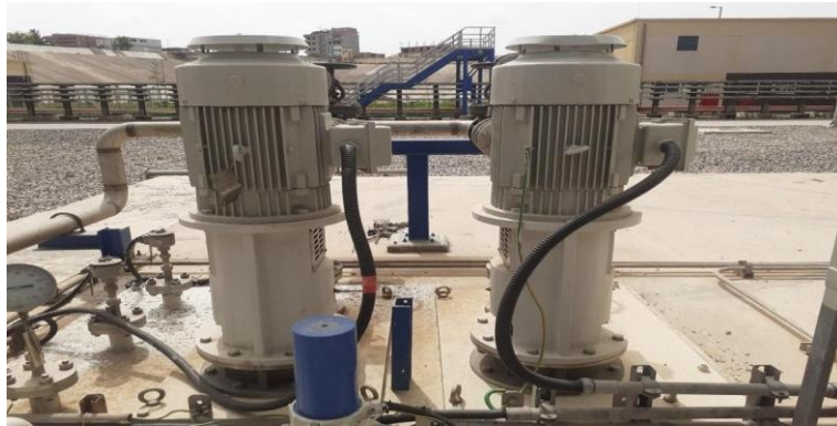
Figure [II.10] : Pompes de rejet
