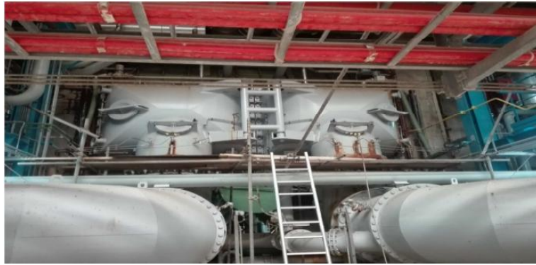
Figure [I.16]: Le Condenseur.
