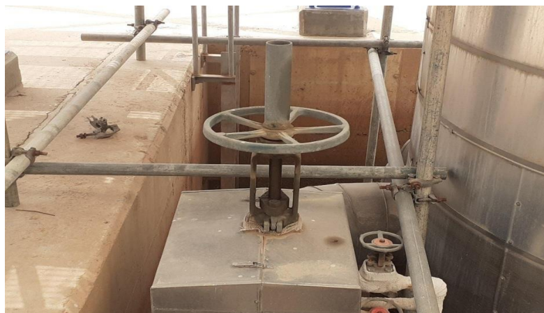
Figure [II.17] : Vanne de transfert vers le bassin collecteur
