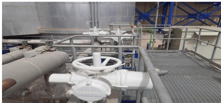
Figure [II.4] : Vannes motorisées de commande des purges
