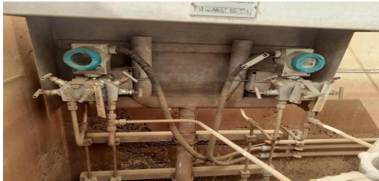
Figure [II.5] : Détecteurs de niveau
