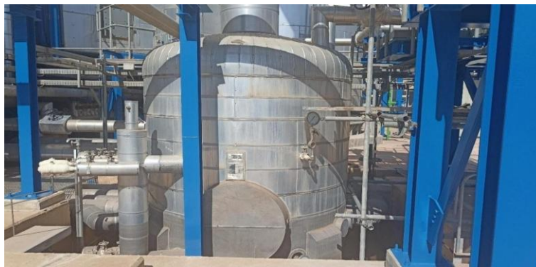
Figure [II.2] : Réservoir des purges
