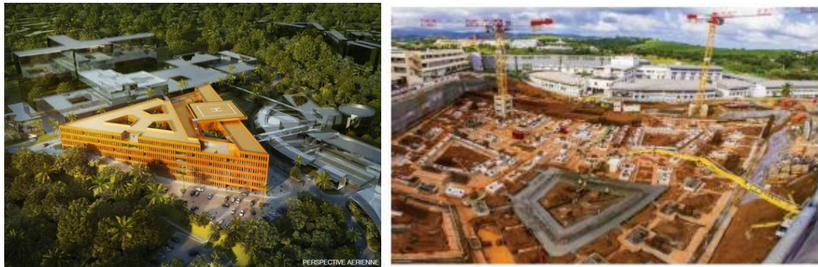
Figure 1.6.a : Hôpital Pierre Zobda-Quitman sur appuis parasismique .
