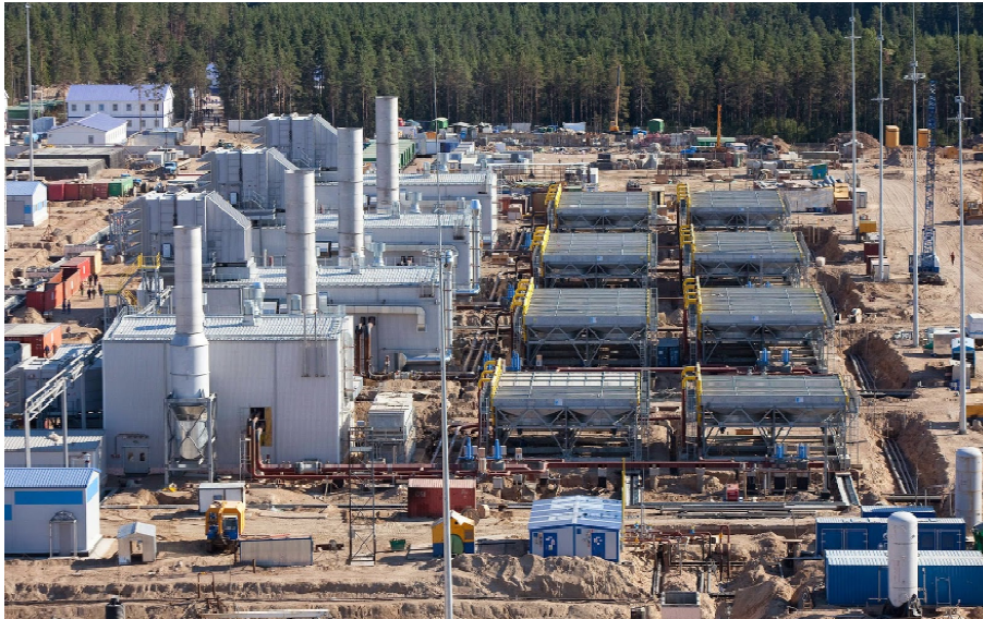
FIGURE 2.5 – Une station de compression avec quatre machines(turbocompresseurs)
