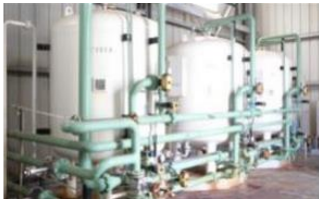
Figure II- 8: Photo des filtres à sable
