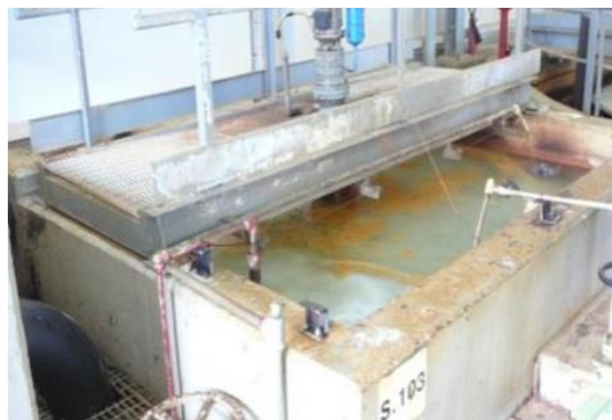
Figure II- 5: Photo de Cuve floculation « S-103 » [14].
