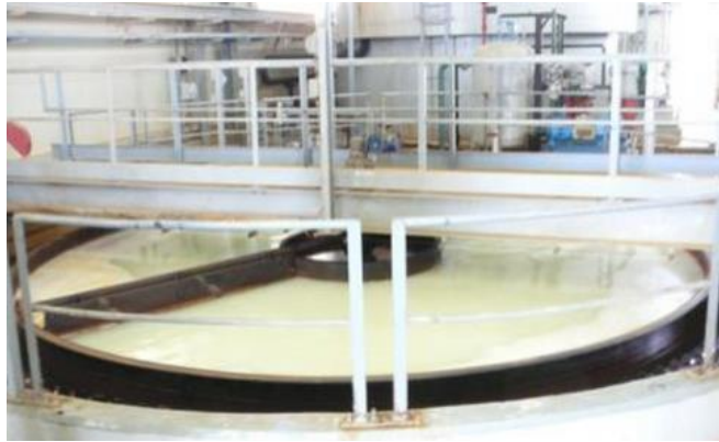
Figure II- 6: Photo de la cuve de flottation « S-104 » [14].
