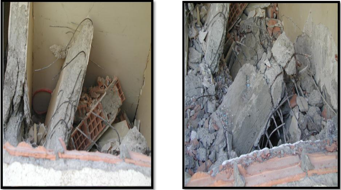
Figure II.10. Eclatement du béton du deuxième volet de la cage d'escaliers avec apparition du ferrailage des deux nappes de la paillasse.
