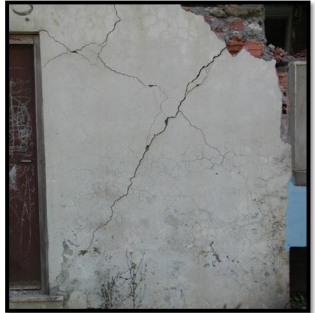
Figure II.5. Fissures en « X ».
