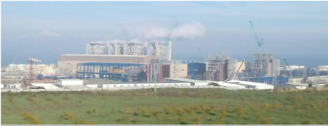
Figure 01 : centrale thermique de Ras-djinet
