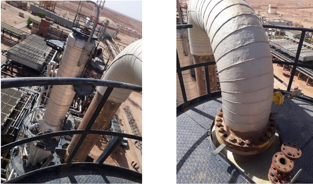
Figure 5.4 : Le sommet de la colonne C-102
