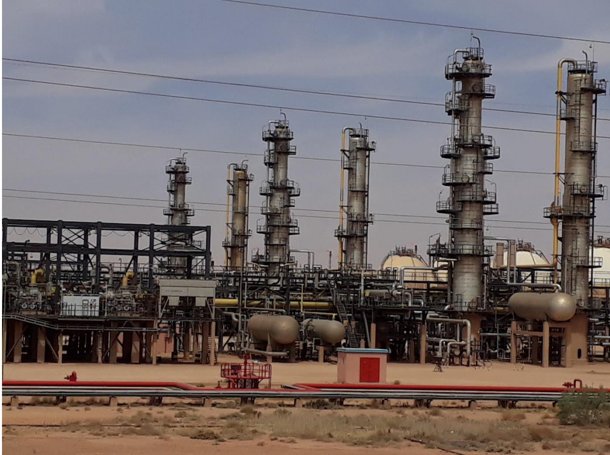
Figure 1.1 : Vue générale du module processing Plant 4 (MPP4).
