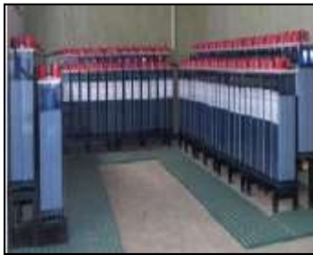
Banc de batteries
