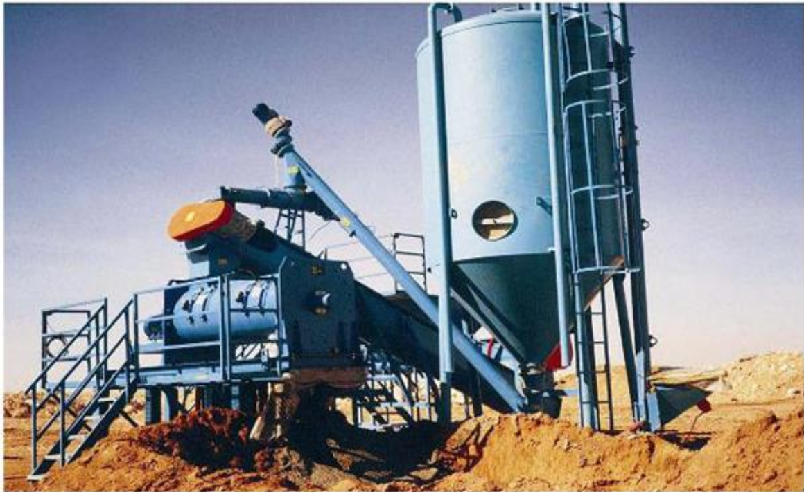
Fig III.5 : L'unité de solidification des déblais de forage (Dry cuttings)
