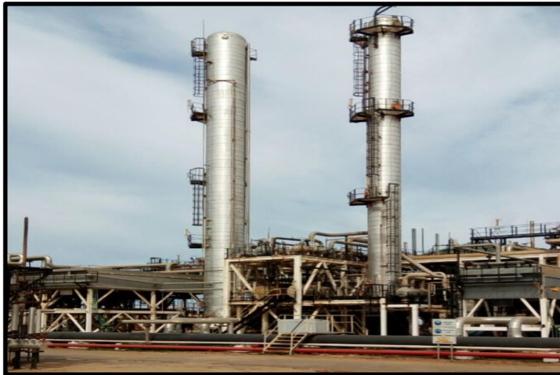
Figure I.12: les deux colonnes de distillation
