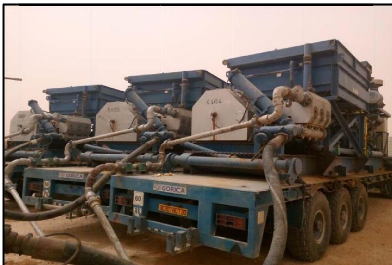
(Figure IV.25) : Pompes à hautes pression (en parallèle)
