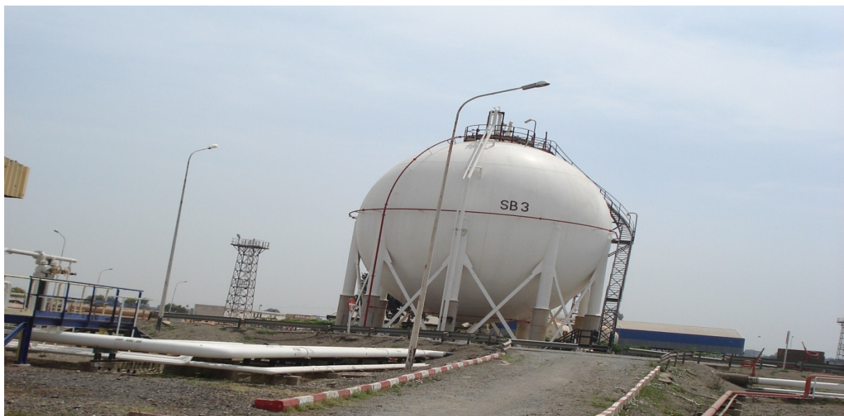
Figure03 : sphère de stockage butane
