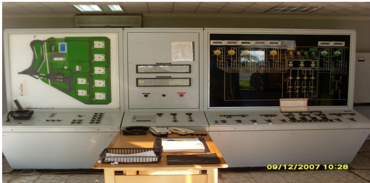
Figure08 : Tableaux de salle de control
