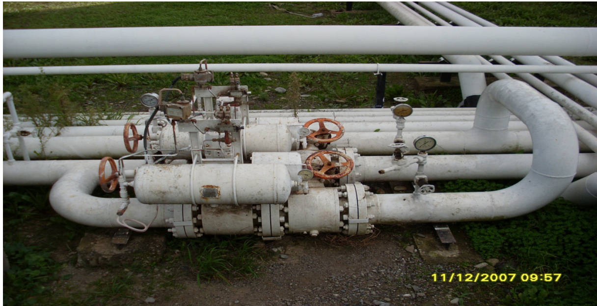
Figure04 : vanne de sélection au niveau de réception
