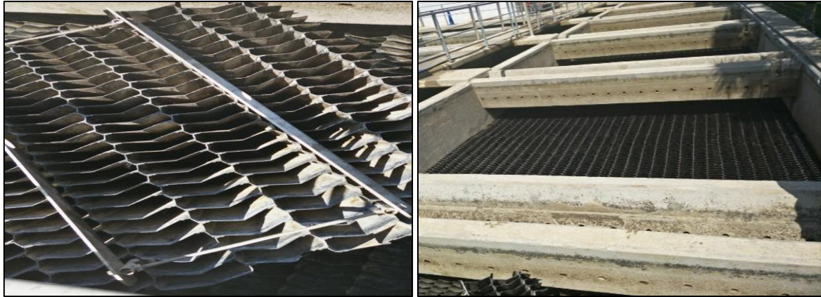
Figure III.10 : Le décanteur Pulsateur Lamellaire de la station de Boudouaou.
