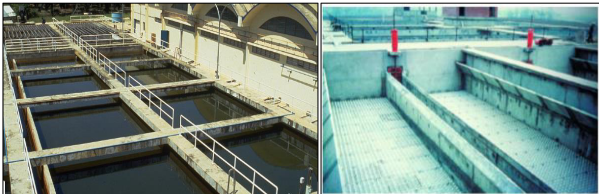
Figure III.20: Filtre à sable de type Aquazur avec une plate forme contient des buselures.
