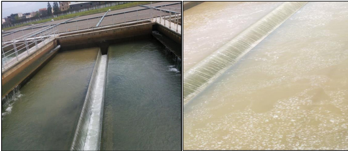
Figure III.22: Filtre Aquazur v de la station SEAAL de Boudouaou lors du lavage.
