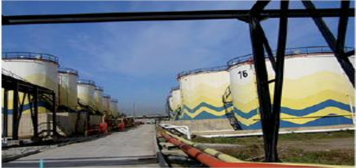
Fig. I.5 : Parc de stockage carburant (document interne)
