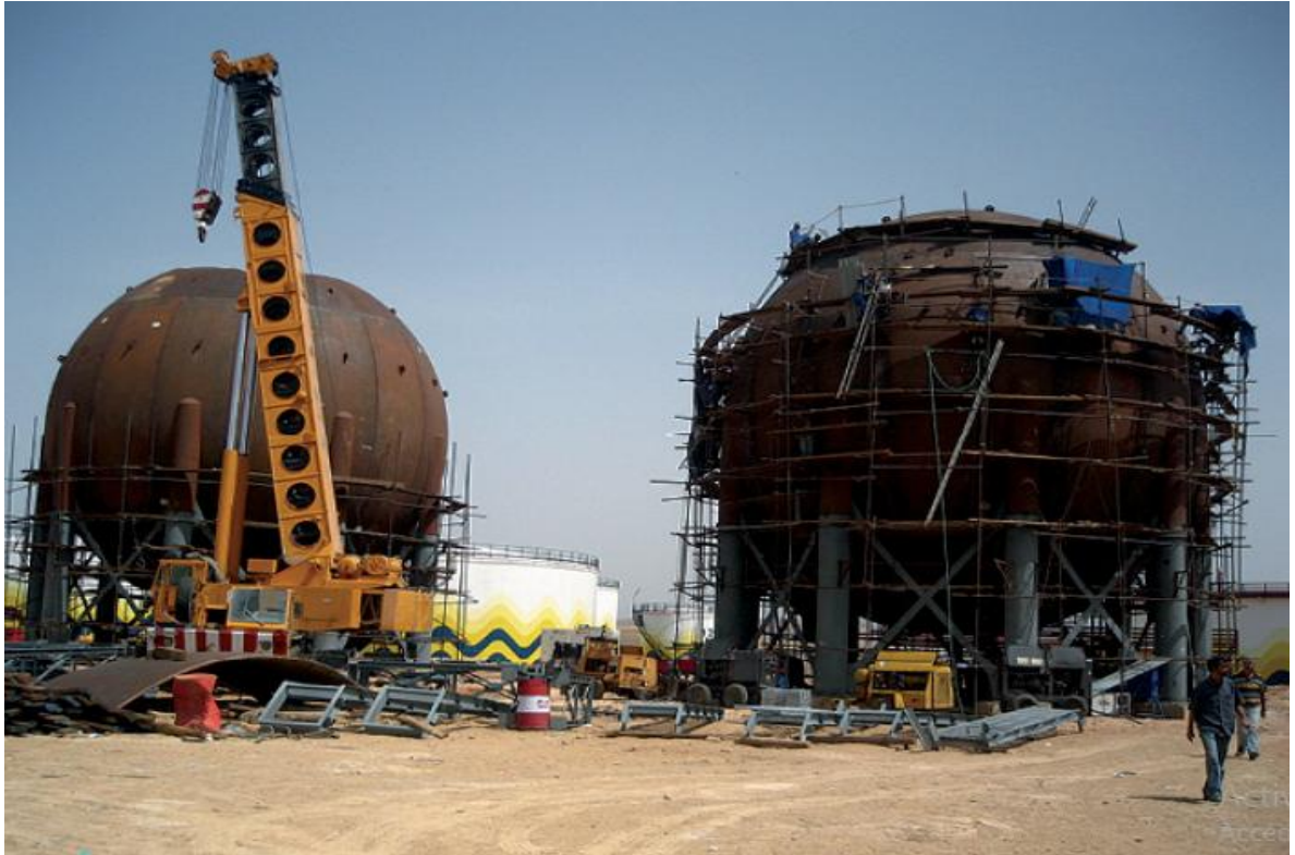
Fig. I.9 : Sphère de stockages GPL (document interne)
