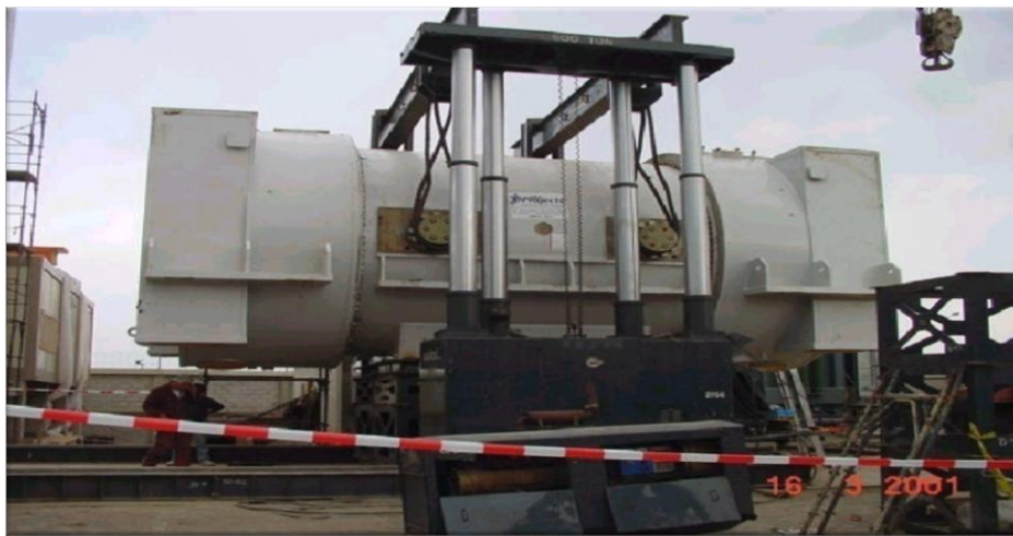
Figure. I. 5: Alternateur de la centrale électrique HAMMA II
