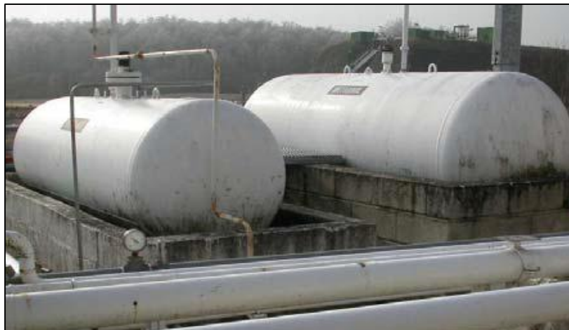
Figure I. 2: Les réservoirs horizontaux.
